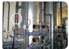
蒸汽管異常溫度偵測
