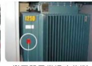
變壓器異常溫度偵測
