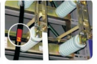
高壓大電纜異常溫度偵測
