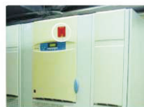
UPS房溫度偵測
