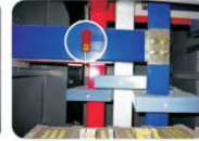
電力匯流排異常溫度偵測
