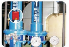
冰水機管路異常溫度偵測
