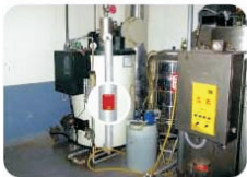
蒸汽管異常溫度偵測
