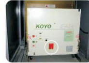
大型 UPS 異常溫度偵測
