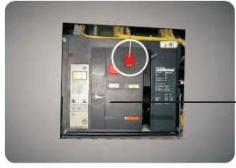
VCB過載異常溫度偵測
