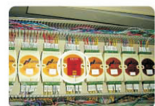
通信環控室異常溫度偵測
