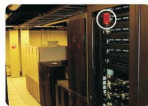
通信機房異常溫度偵測
